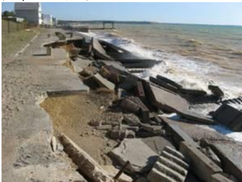
Рисунок 1.2.5-1 Состояние разрушенных берегоукрепительных сооружений у с. Береговое
