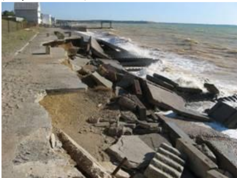
Рисунок 1.2.5-1 Состояние разрушенных берегоукрепительных сооружений у с. Береговое
